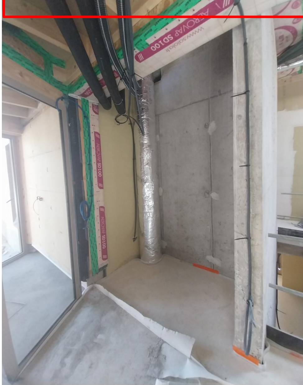
Descente de câble vers RDC
