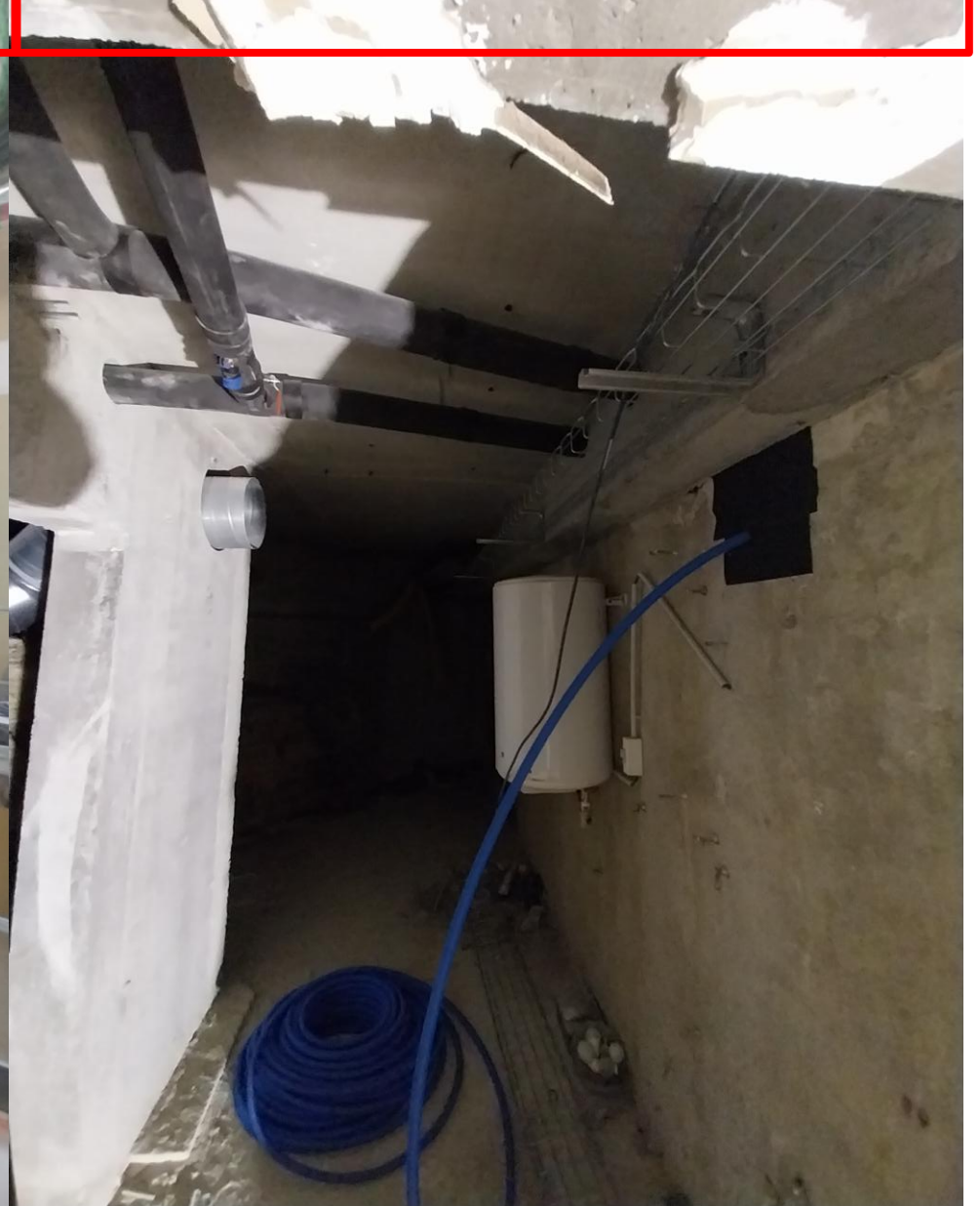
Cheminement de câble vers TGBT
