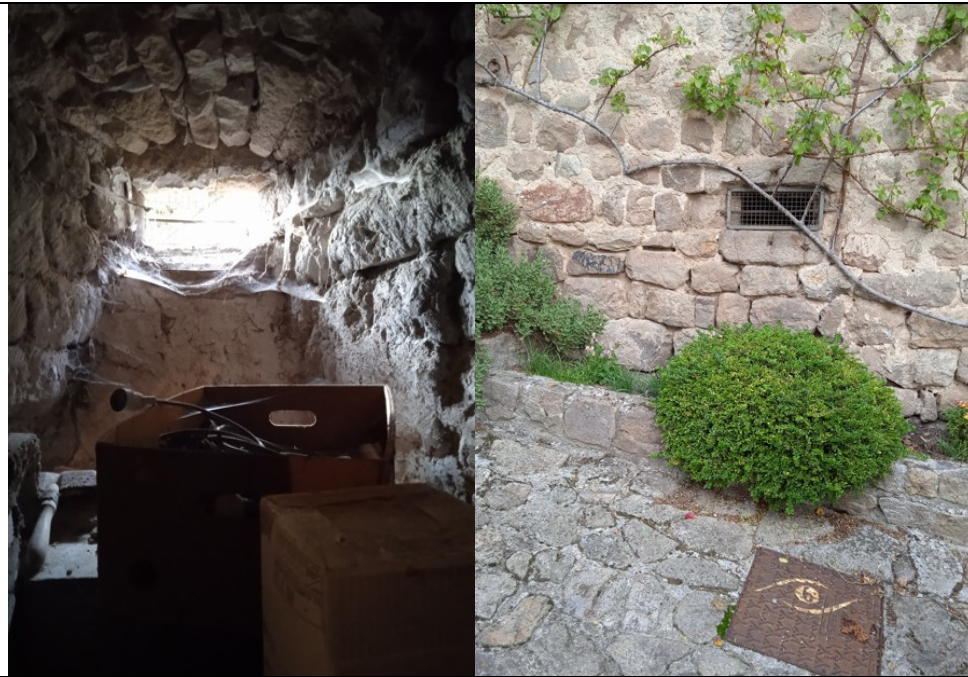
Soupirail existant dans la cave afin de permettre l'alimentation en plaquettes par soufflage
