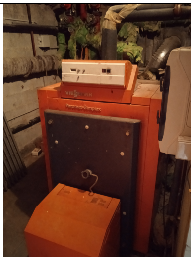
Chaudière fioul actuelle gîte les Blés d'or - 130KW de 1998
