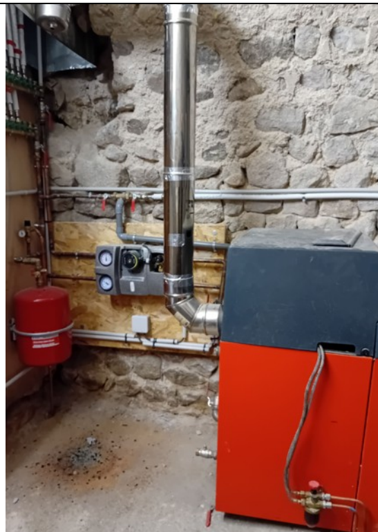
Chaudière existante fioul du gite Les Ruches
